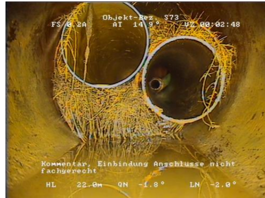
Abbildung 8: Wurzeleinwuchs S73 - S74
